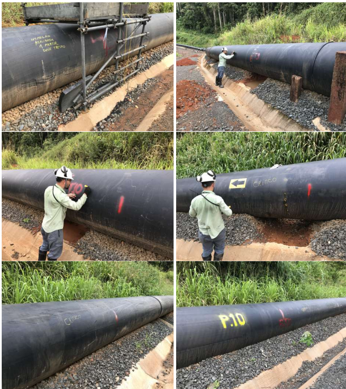
Figura 23 – Marcação dos trechos comprometidos da tubulação
